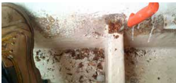
Det främre skottet när jag upptäckte att plywooden var fuktig.
